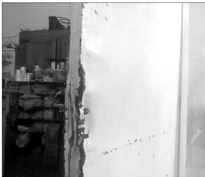
Estado en el que quedó la puerta por donde intentó ingresar el malviviente al comercio local.
